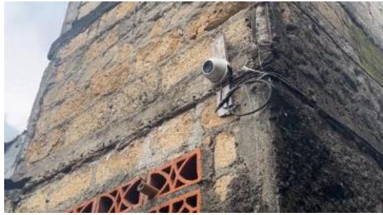
Gambar 3. Dokumentasi CCTV Yang Sudah Terpasang Di Daerah Duri Kepa
